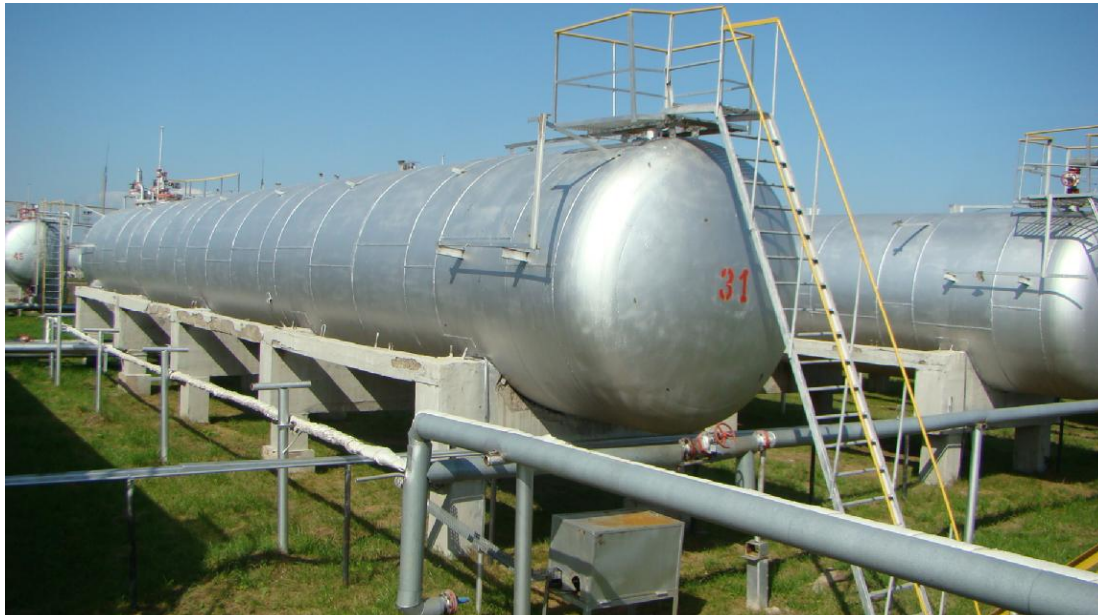
Рисунок 1 - Общий вид резервуаров стальных горизонтальных цилиндрических РГС-175
