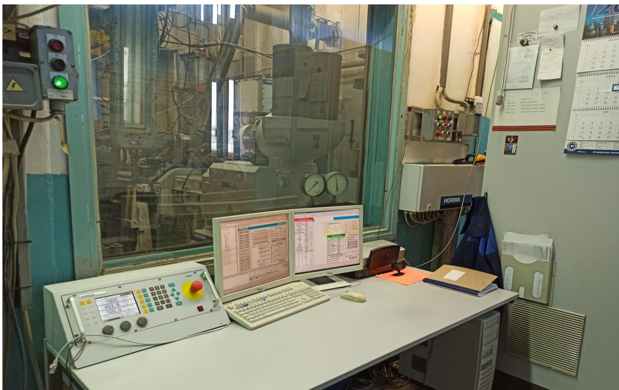
Рисунок 6 – Помещение пультовой, место оператора
