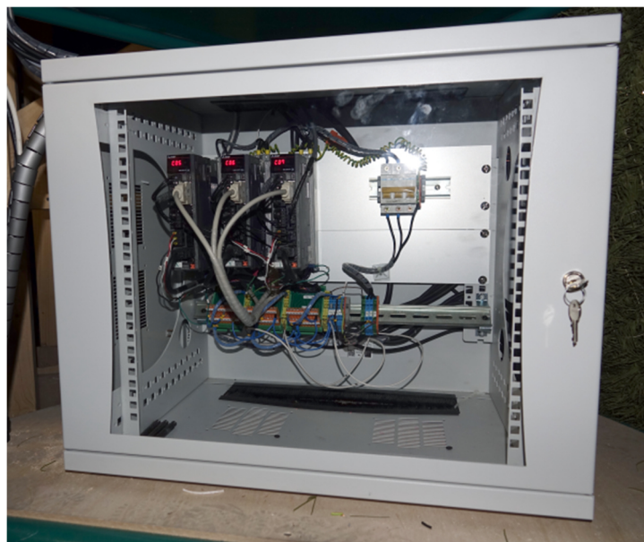
б) Шкаф А02
