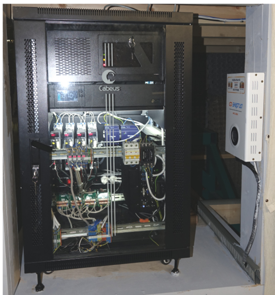
а) Шкаф А01
