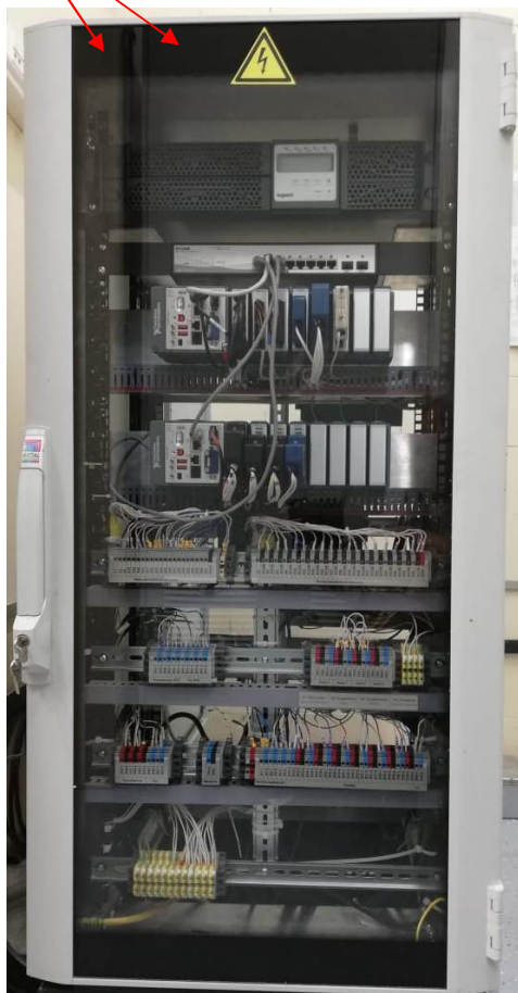
Рисунок 1 – Общий вид электромонтажного шкафа
