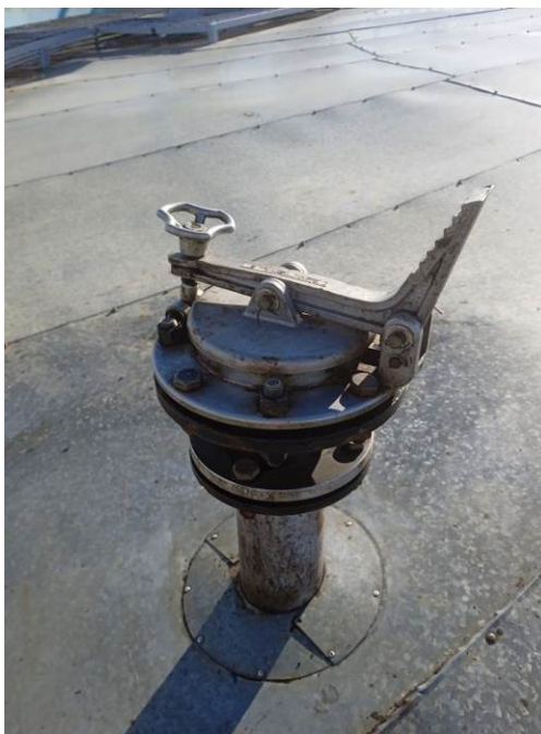
Рисунок 2 –Замерной люк резервуара
