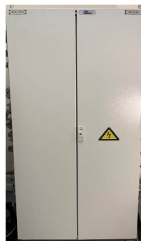
Рисунок 4 – Шкаф соединительный ( в закрытом виде)
