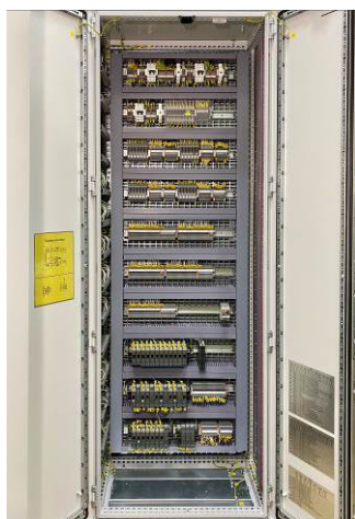
Рисунок 3 – Шкаф соединительный ( в открытом виде)
