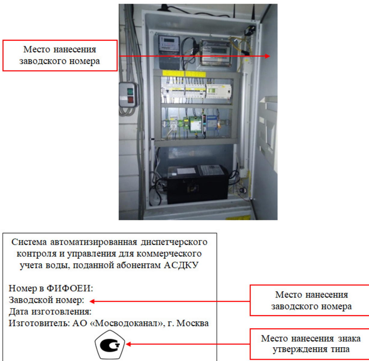
Рисунок 2 – Комплексный и связующий компоненты, установленные в шкафу сбора и передачи данных
